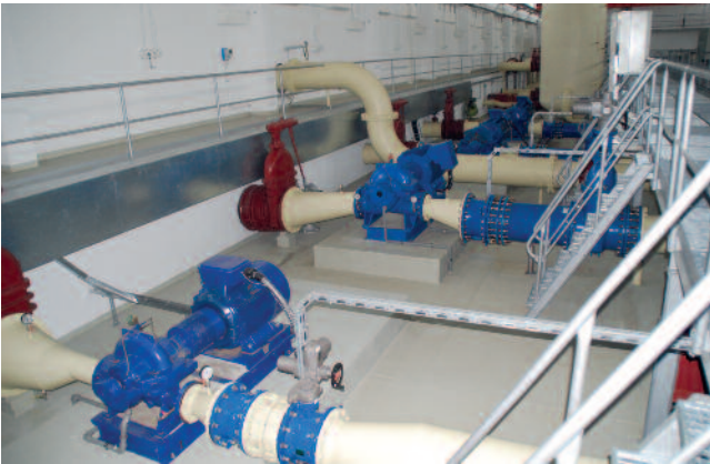
Die alten Pumpen im Wasserwerk Fichtenberg, die durch neue ersetzt werden.
